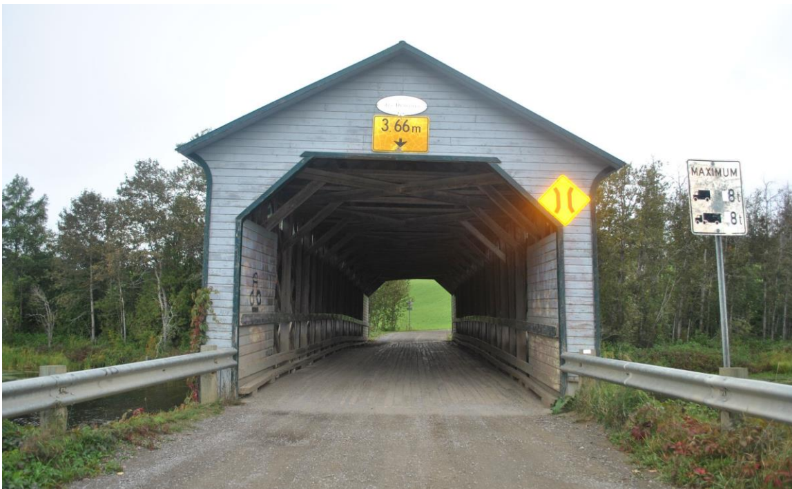
Fig. 26. Les abords et le portique d'entrée du côté ouest, vue vers le pont [2020-09-09 P-06466 Draveurs IPS-Photo ERR_DSC_0597.JPG]
