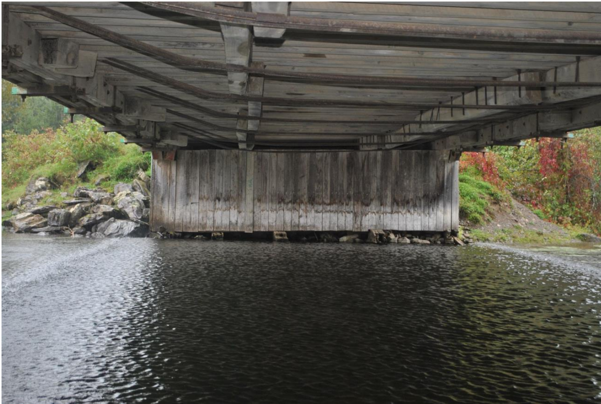
Fig. 19. On voit le système de renforcement du platelage ajouté dans les années 1950. [2020-09-09 P-06466 Draveurs IPS-Photo ERR_DSC_8018.JPG]
