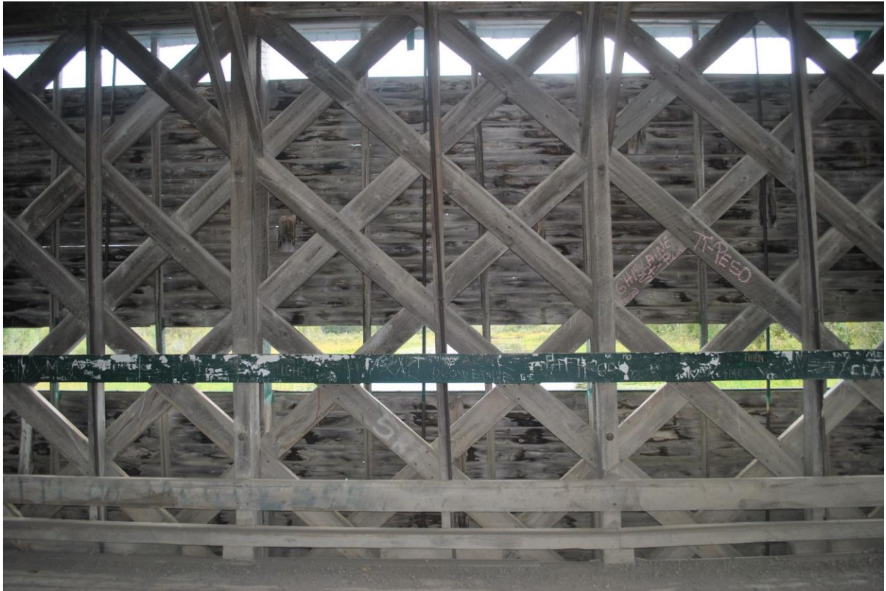
Fig. 34. Ferme de type « Town québécois », ouvertures latérales et cordes simples. On voit les tiges métalliques faisant partie du système de rigidité des fermes. [2020-09-09 P-06466 Draveurs IPS-Photo ERR_DSC_0585.JPG]
