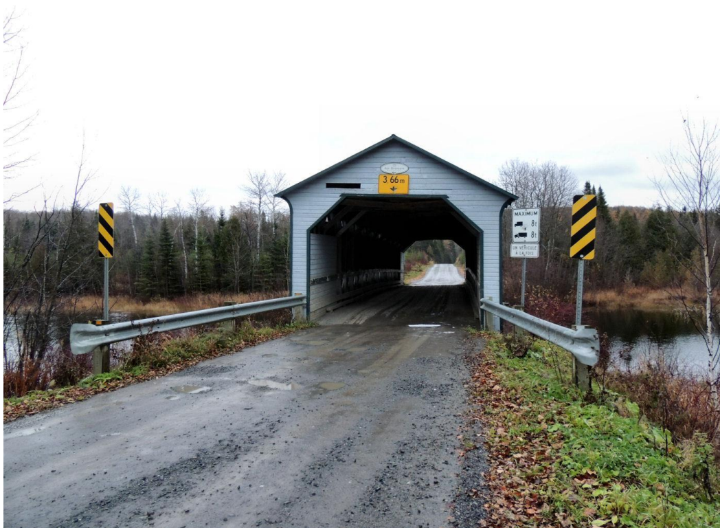
Fig. 17. On voit sur cette photo du pont prise en 2015 que le portique est légèrement abîmé. Photo : Gérald Arbour via pontscouverts.com
