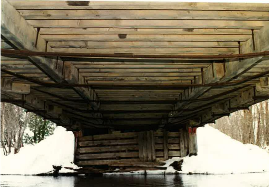
Fig. 12. Sur cette photo de 1991, on remarque la culée abîmée et que les lambris verticaux sont pratiquement disparus. On constate aussi que les traverses du tablier du pont sont supportées par les cordes inférieures et par deux longerons soutenus par des tiges métalliques. Tiré de Jean, Régis. Évaluation patrimoniale des ponts couverts de la Municipalité régionale de comté de Rimouski-Neigette . Québec, Ministère de la Culture, 1990. p.46.
