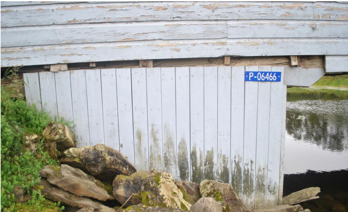
Fig. 20. On remarque que le jet d'eau aux culées a été retirée. [2020-09-09 P-06466 Draveurs IPS-Photo ERR_DSC_0605.JPG]
