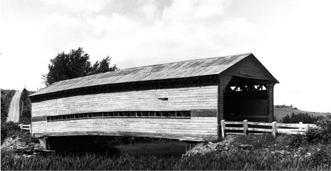
Fig. 8. Vue sur l'entrée est (rive droite) du pont des Draveurs avant 1982. On constate que l'état du portique s'est encore détérioré. Photo : Joseph D. Conwill, Pont'Âge , été 1985, vol. 4, no. 4, p. 5.
