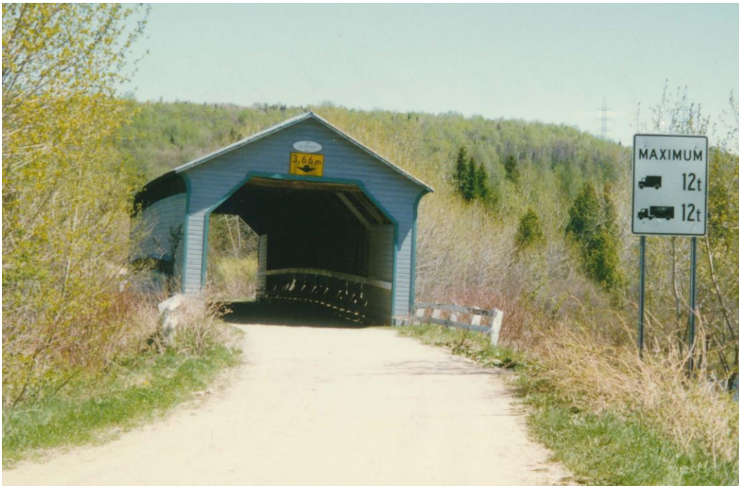
Fig. 14. Pont des Drapeurs en 1997. On remarque que l'extérieur du pont paraît en bon état et que la charge maximale indiquée est de 12 tonnes. Les culées n'ont toutefois pas encore été réparées à cette époque. Dossier P-06466 : 1997-06-03 P-06466 Photos - Mont Lebel - DS.pdf
