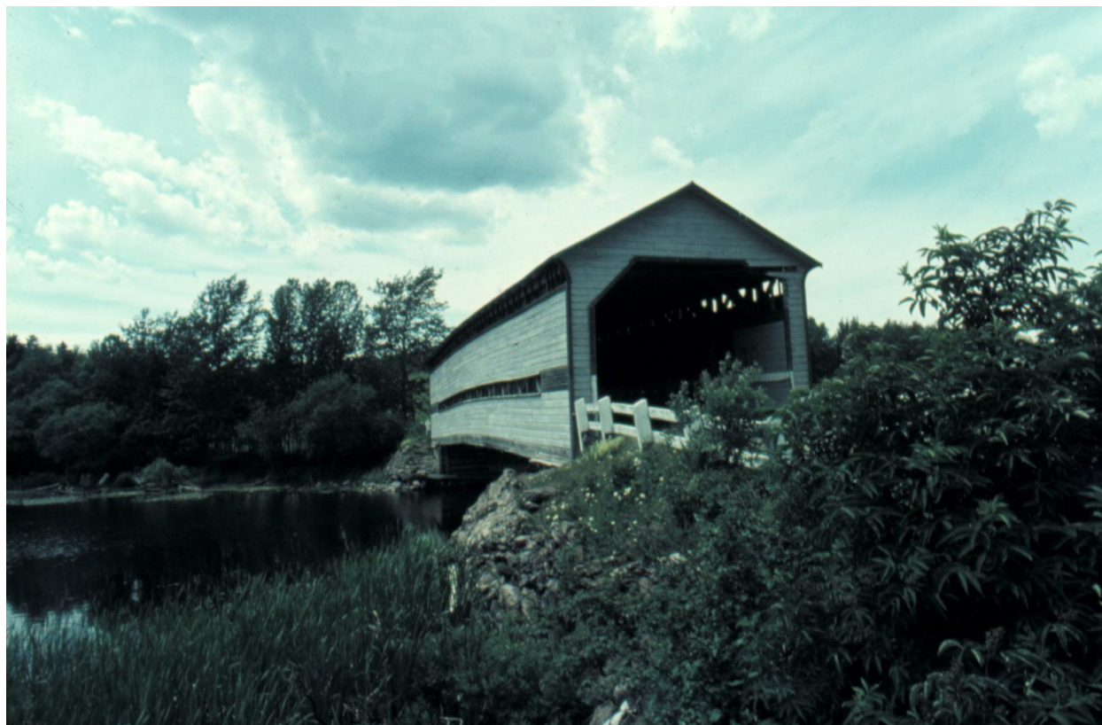
Fig. 7. Vue sur l'entrée est (rive droite) du pont couvert en 1970. On constate que le portique est abîmé. Photo Pascal Conner, via pontscouverts.com
